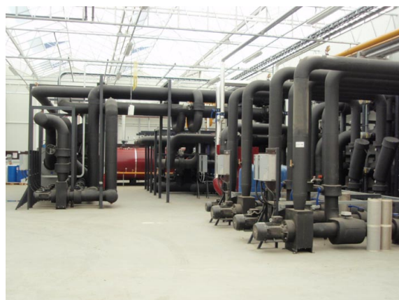
図6 半閉鎖型ハウスでのヒートポンプと空調のための配管
